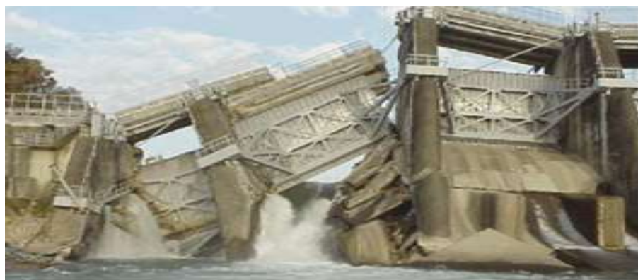
Рис.4.Разрушение плотины Ши-Кань на Тайване во время землетрясения Чи-Чи 21.09.1999 г [1,2].
