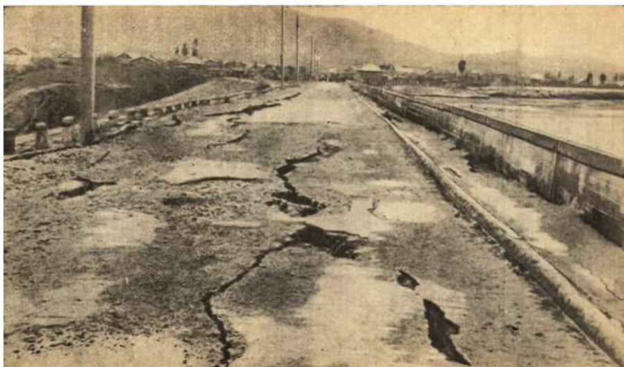
Рис.6. Повреждения плотины Чирюртской ГЭС при Дагестанском землетрясении 14.05.1976 года [6].
