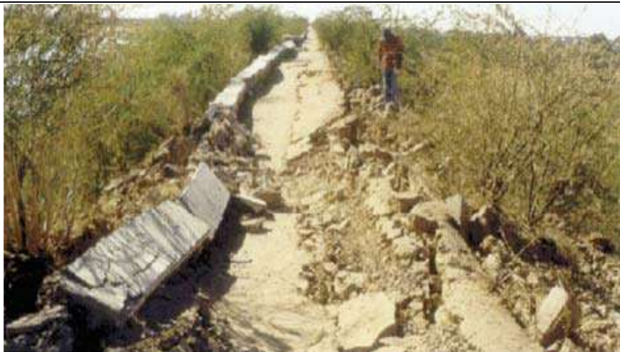
Рис. 5. Продольные трещины на верховой грани плотины Фейтигадх (Индия), вызванные землетрясением Бхудж 26.01.2001 г. [1,2].
